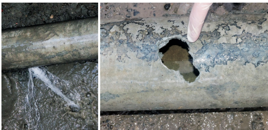
Figura 2 - Tubazione idrica in cemento amianto lesionata.
