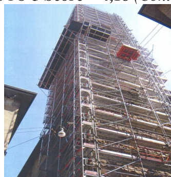
(Rischio caduta con ponteggio protetto)
