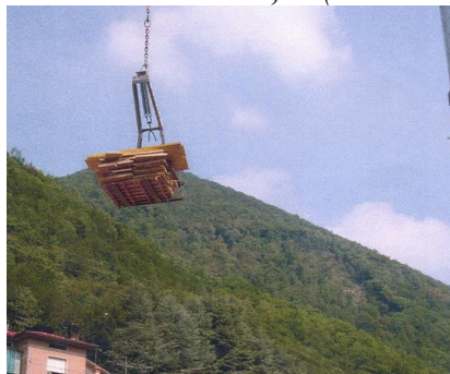
(Rischio caduta materiali)
