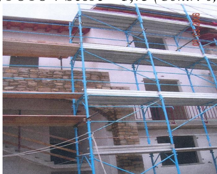
(Rischio caduta con ponteggio parzialmente protetto)
