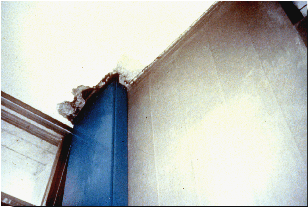
Figura 13 – Degrado spontaneo di solaio contenente amianto
