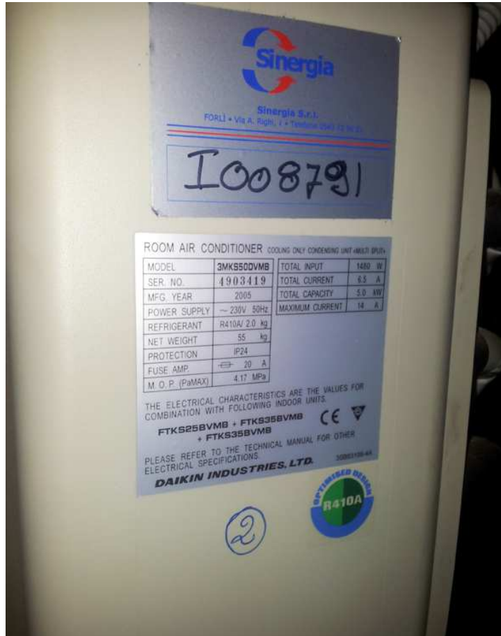
Figura 6. Uno dei numerosi sistemi di raffrescamento estivo mobili presenti all'interno dell'edificio
