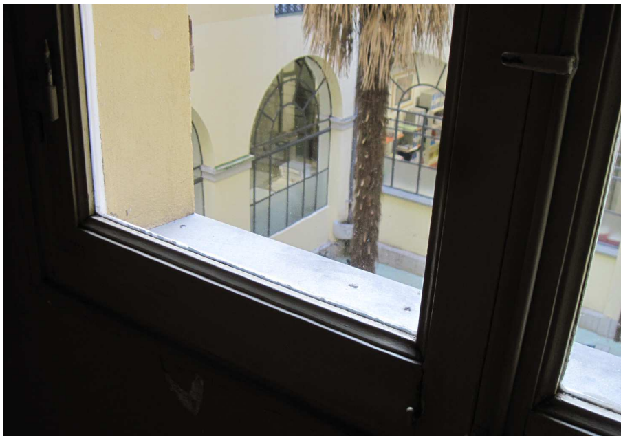
Figura 4. Infissi il legno con vetro singolo. Tale tipologia di infisso è presente in tutti gli ambienti di passaggio (scale e corridoi).
