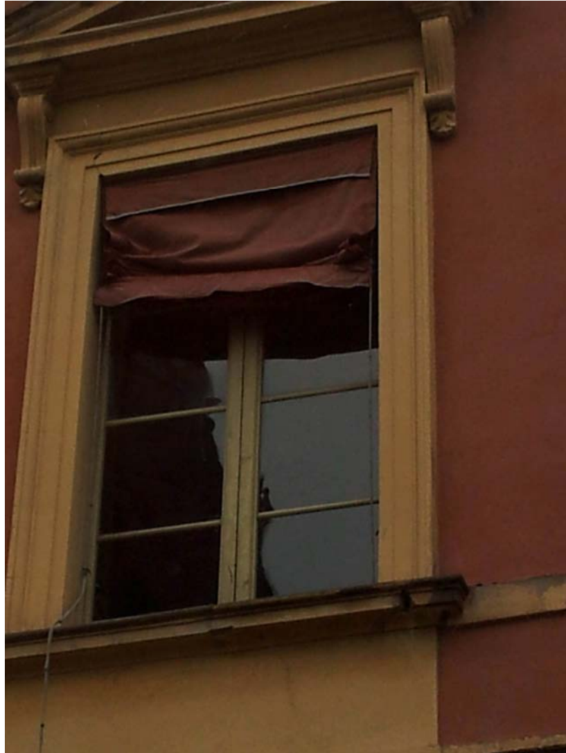
Figura 5. Infissi in legno con vetri singoli in precario stato di conservazione.
