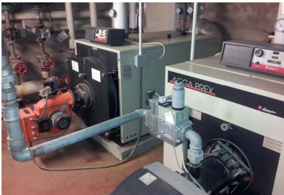
Figura 7. Le caldaie alimentate a gas metano presenti all'interno della centrale termica dell'edificio
