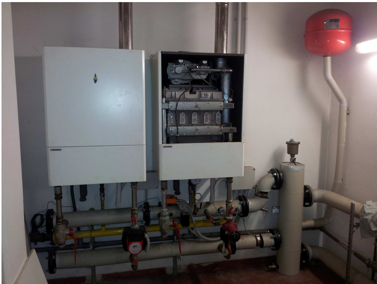
Figura 5. Le due caldaie Ecoflam Blumax 80 presenti all'interno della centrale termica
