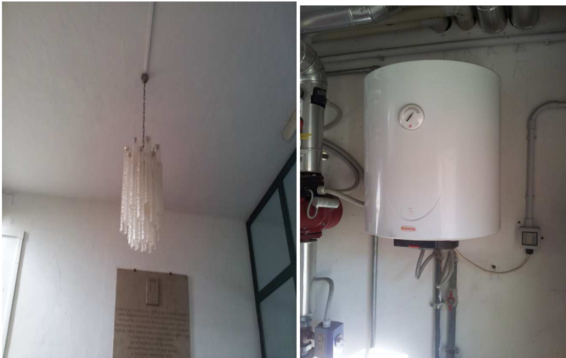
Figure 7 e 8. Il lampadario posto all'ingresso del Municipio ed il boiler per la produzione di ACS
