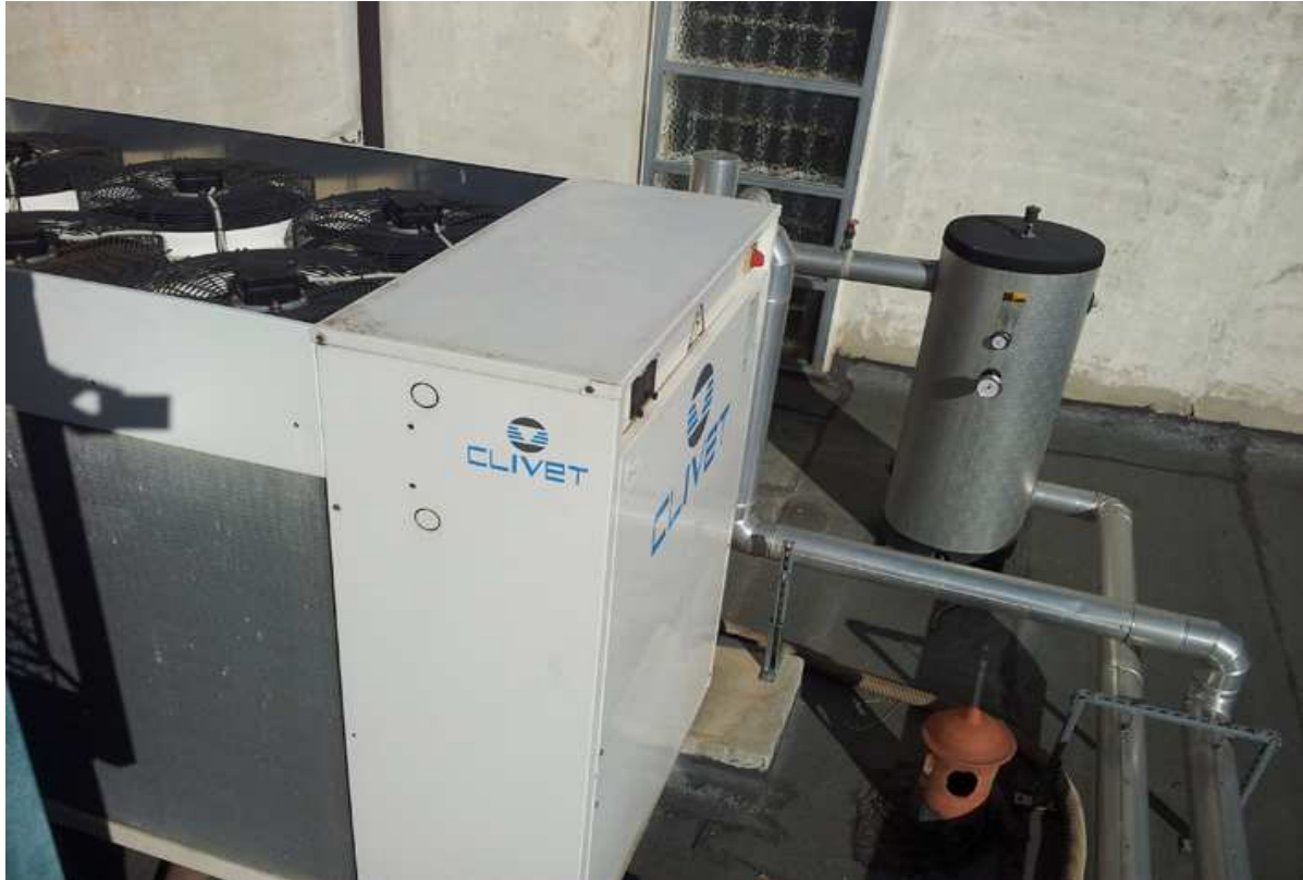
Figura 10. L'unità esterna dell'impianto di climatizzazione estiva
