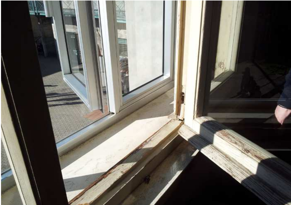
Figura 6. Infissi doppi presenti su tutti i rimanenti fronti dell'edificio caratterizzati dalla presenza di legno + vetro singolo (interno) e alluminio + vetro singolo (esterno)
